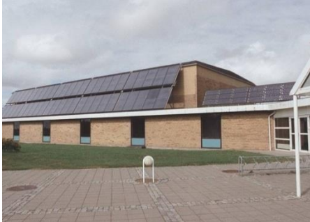
Figur 28. Installation med plana solfångare. Foto: Arcon/ ESTIF
