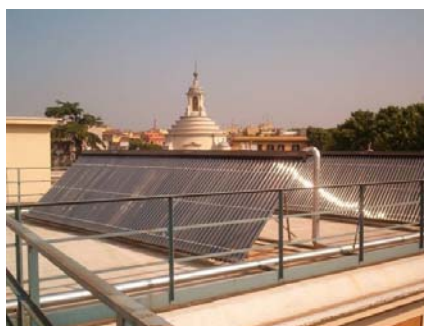
Figur 2. Installation med vakuumrörsolfångare. Foto: Thermomax/ ESTIF
