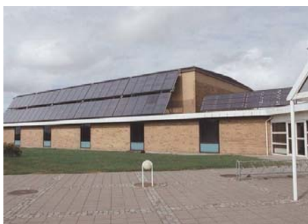
Figur 1. Installation med plana solfångare. Foto: Arcon/ ESTIF
